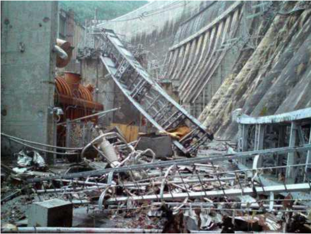
Рис. 7. Плотина Саяно-Шушенской ГЭС (Россия), авария, 2009 г.
